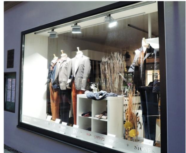
Schaufensterbeleuchtung mit YES-3-Phasen-Strahlern
